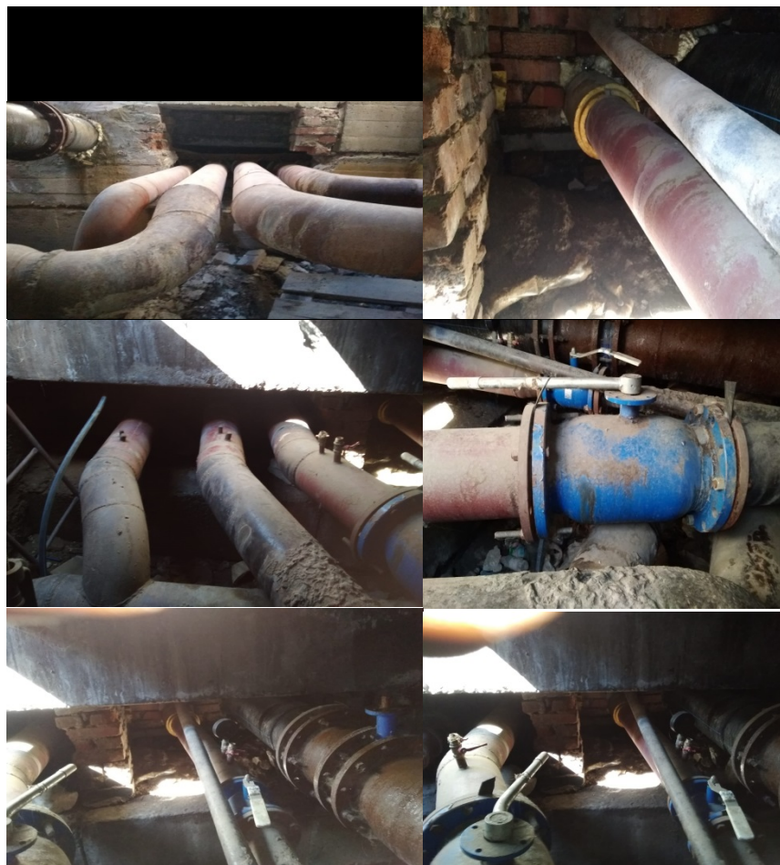
Участок сетей ГВС заменен в 2025 году, состояние трубопроводов и запорной арматуры удовлетворительное
